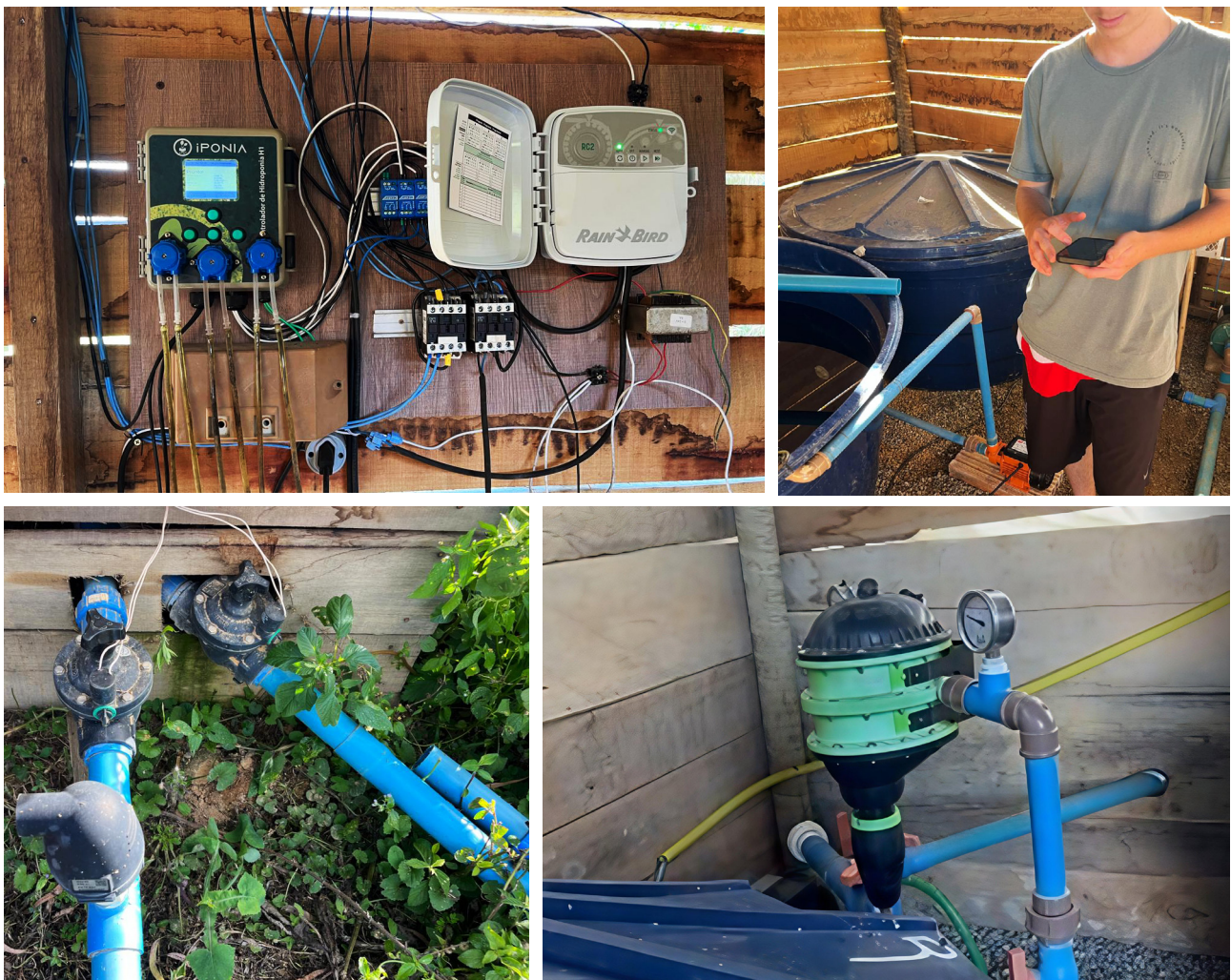
Figura 3 – Partes do sistema de irrigação: reservatórios de água e painel de controle conectado ao celular.
